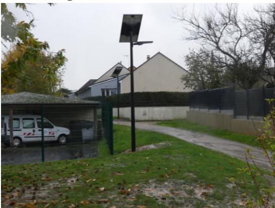
Éclairage solaire cheminement Châtaigniers
