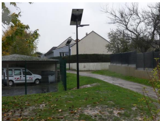
Éclairage solaire cheminement Châtaigniers
